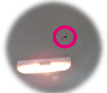
BESCHÄDIGTER DACHHIMMEL (LOCH)
