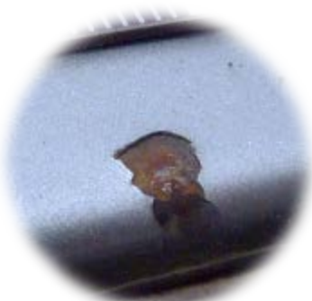
ROST - BESCHÄDIGTE GRUNDIERUNG
